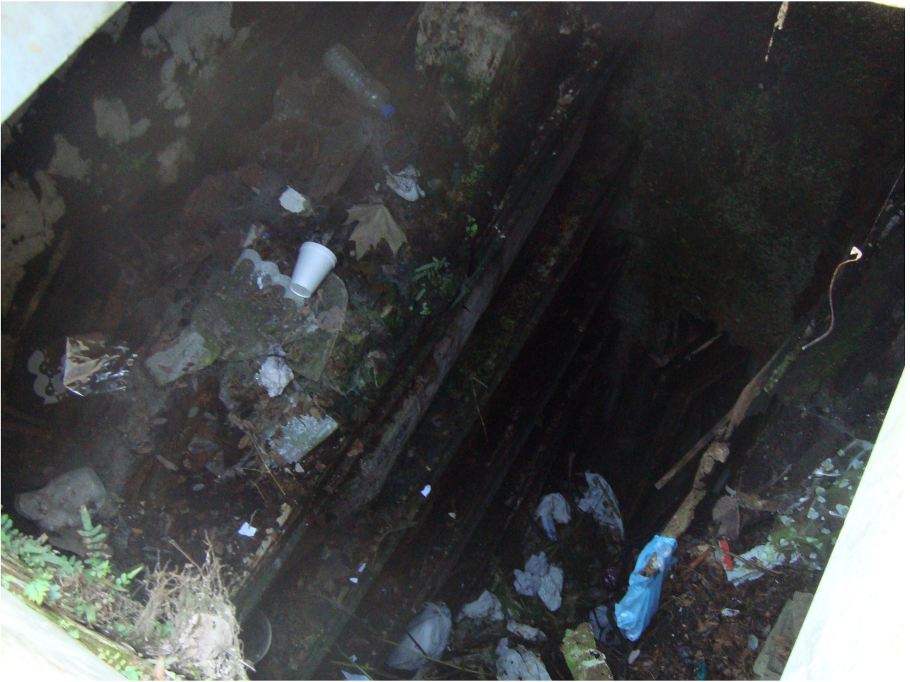
FOTO 5. Interior de bóveda (ver foto anterior). Puede apreciarse los cajones apilados unos sobre otros entre la basura
